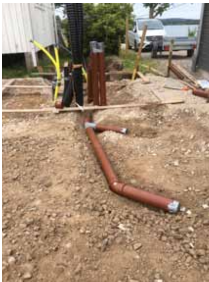
Avloppsrör till Attefallshuset trinett på kontroret och vask i förrådet. I detta fall 110 mm:s rör.
