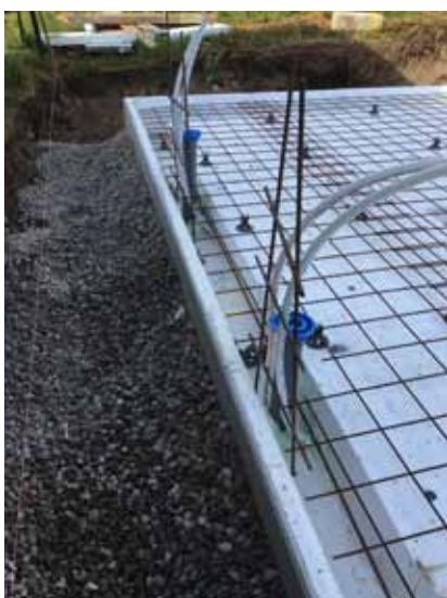
Avlopp, kall- och varmvatten i A- tefallsbyggnaden.
