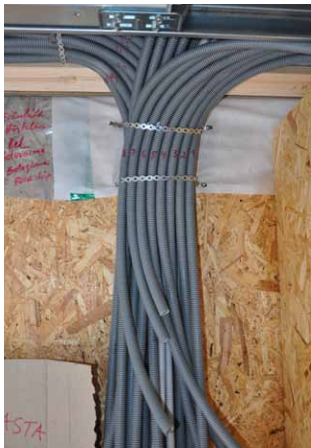
Exempel på förläggning till central och mediaplatsen i friggeboden.
