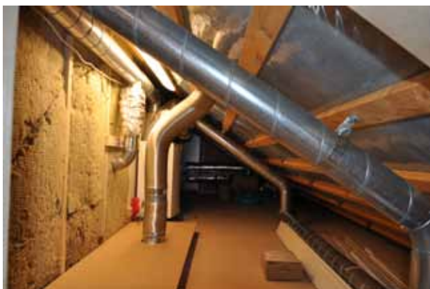
Här är hela installationen klar. I framkant av bilden ser man anslutningen till vår spisfläkt.
