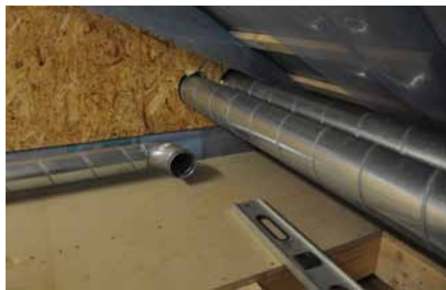
Ventilationsrörens framfart... Rören försägs med ljud-dämpning vid varje till- och frånluftdon.
